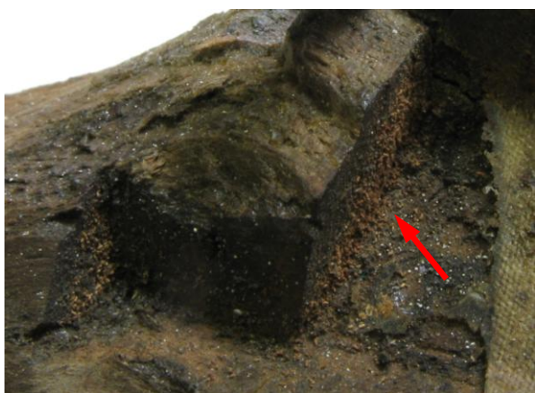
Obr.: Korozní produkty železa
