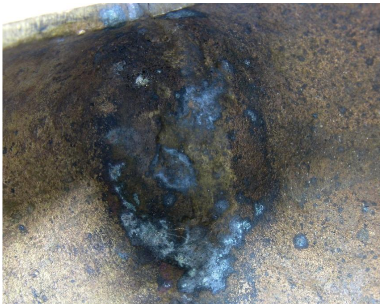
Obr.: Zelené korozní produkty základního kovu
